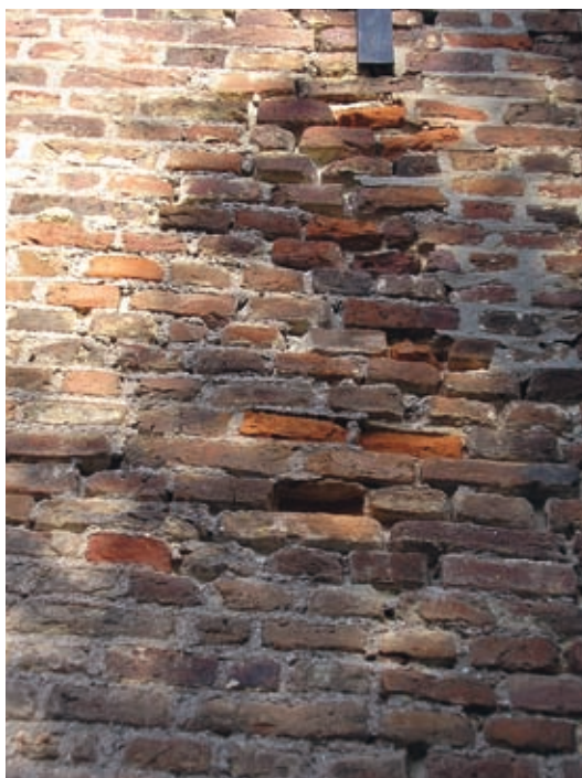
Diep uitgesleten voegwerk en beschadigde stenen
